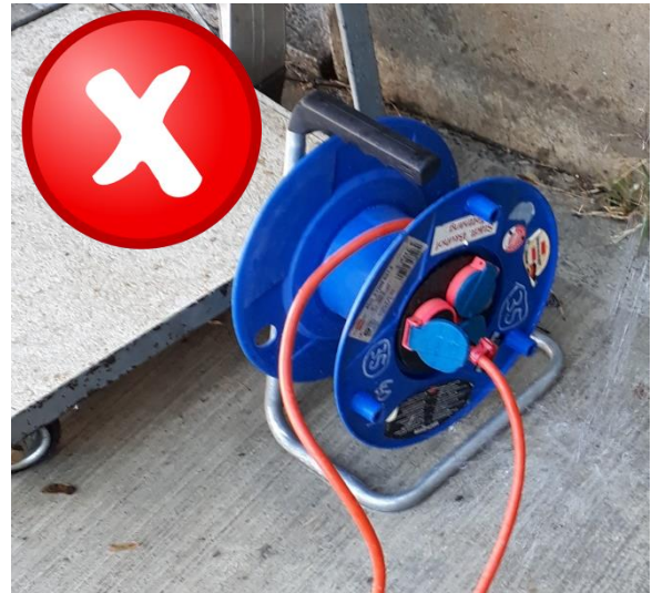
Kabeltrommel auf den Boden stellen!
