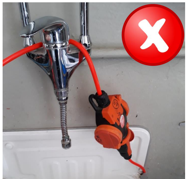
Stromanschluss neben Wasseranschluss.
