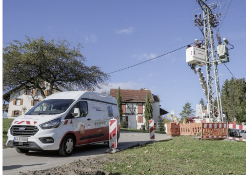
Das Regionalwerk Bodensee investierte wieder ordentlich in die 1.400 Kilometer Strom- und Gasnetze.
